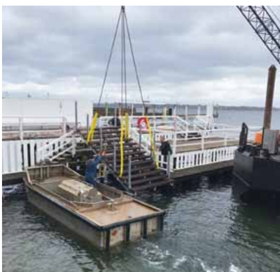
Die größte Baumaßnahme war die Treppenerneuerung. Die alte Treppe wurde abgebaut und durch eine aus Stahl ersetzt.
